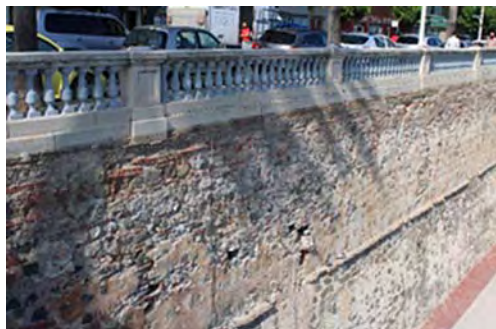
Pérdida de revestimientos.
