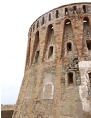
Pérdida de elementos de la fábrica.
