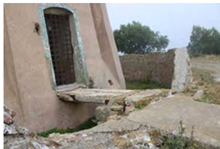
Pasarela y muro del foso en estado ruinoso.
