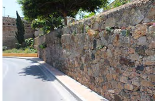
Grieta en el elemento.
