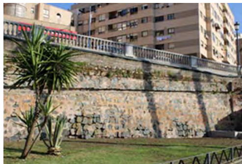
Pérdida de revestimiento en la mampostería y vegetación parasitaria.
