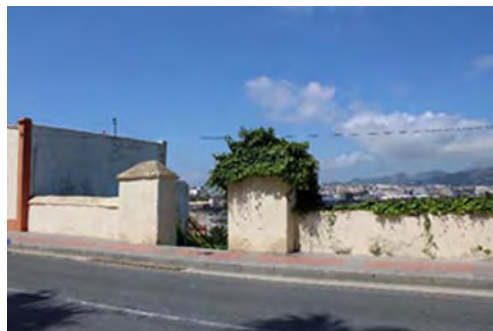
Vegetación parasitaria sobre machón y muro.
