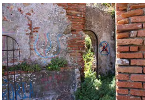
Vandalismo en el inmueble.
