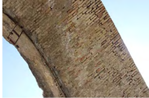
Pérdida de material y elementos oxidados.
