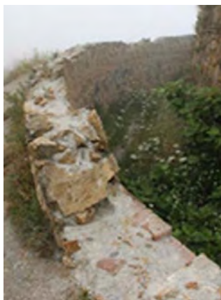
Foso colmatado de vegetación
