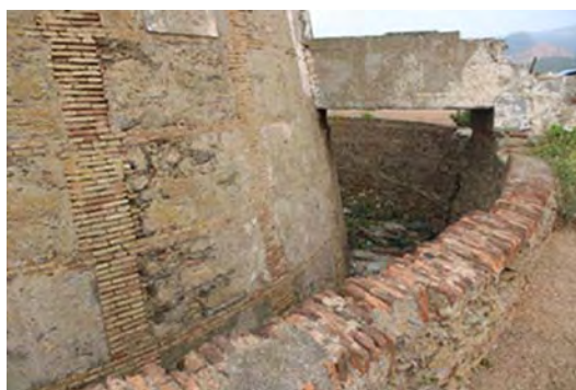
Foso seco y suciedad. Pasarela en muy mal estado.
