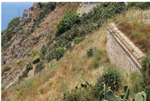
Líquenes en la coronación del muro.
