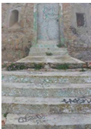
Plataforma de acceso en ruina y pintadas vandálicas en el elemento
