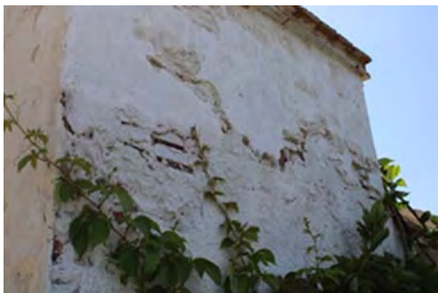
Erosión y pérdida de material.
