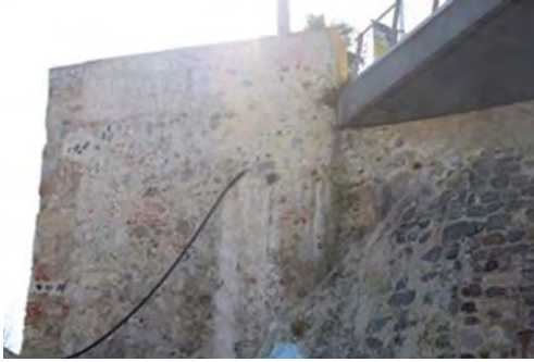
Vegetación parasitaria, ensuciamiento y línea de instalaciones mal resuelta.
