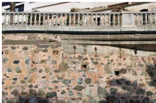
Manchas de oxidación.
