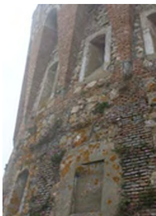
Moho y líquenes en la fachada del elemento
