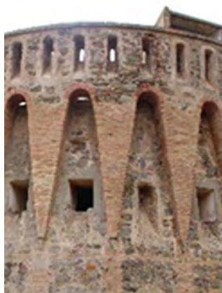
Pérdida de revestimiento.
