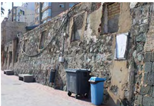
Huecos tapiados y cartelería en mal estado.
