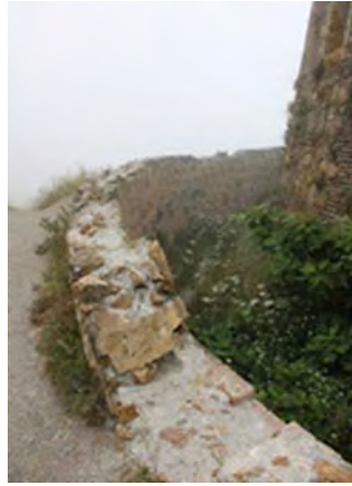
Pérdida de revestimientos y piezas.
