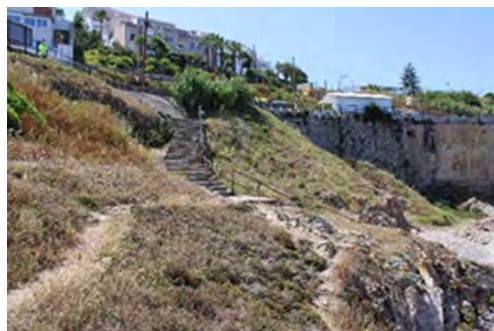
Falta de mantenimiento.
