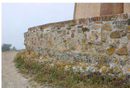
Moho y líquenes en las zonas en sombra.
