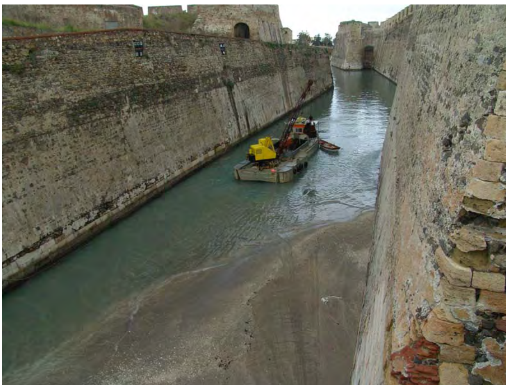
Figura 5. Cierre del foso de las Murallas Reales como consecuencia de la arena depositada en la playa de la Ribera (foto Quino Sánchez).
