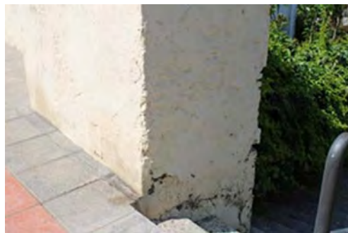
Pérdida de los enfoscados.
