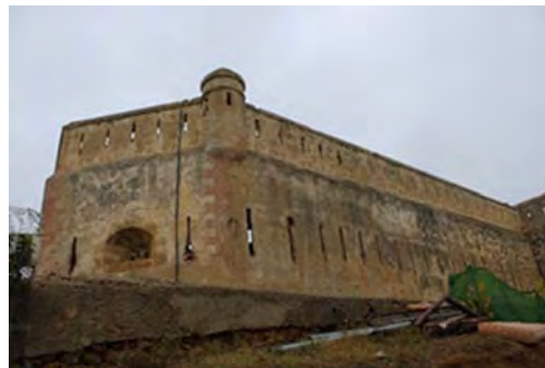
Deterioro visual del elemento.
