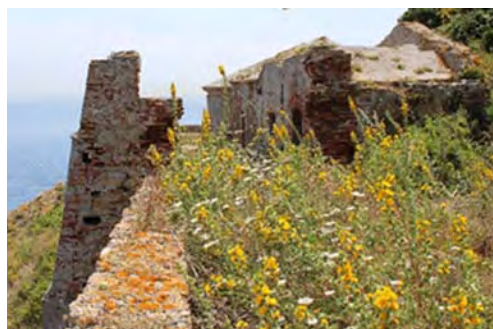
Acceso inaccesible por la vegetación.
