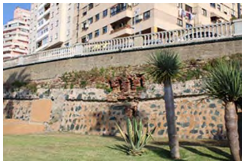
Pérdida de revestimiento en la fábrica y existencia de vegetación parasitaria.
