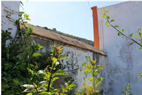
Humedades en machones y muros.
