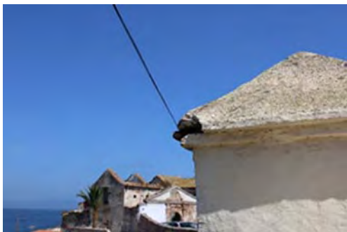
Pérdida de material en la albardilla.
