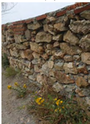
Pérdida de piezas de piedra
