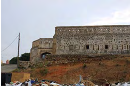
Suciedad en el entorno y pérdida de material en el basamento.
