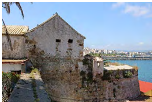
Vegetación parasitaria y pérdida de revestimientos generalizados.
