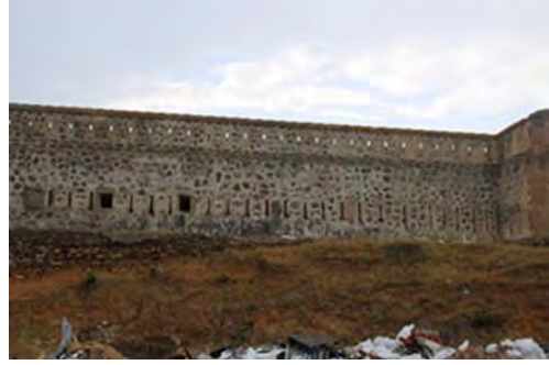
Suciedad y pérdida de material en el contorno de los huecos.
