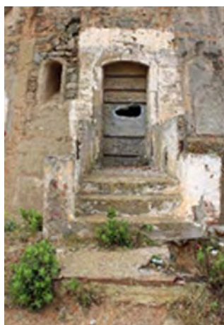
Pasarela de entrada en ruina.
