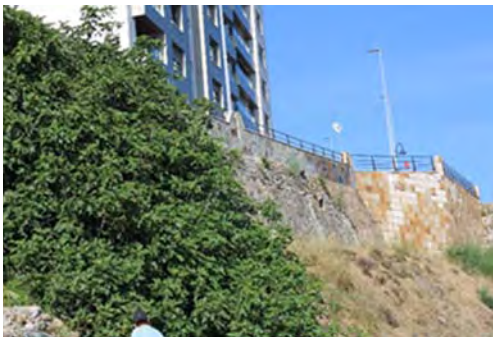
Ensuciamiento del elemento.
