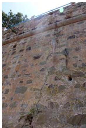
Fisuras y grietas.
