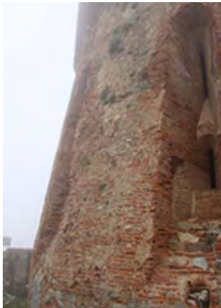
Perdida del revestimiento.
