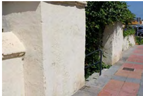
Humedad de capilaridad.
