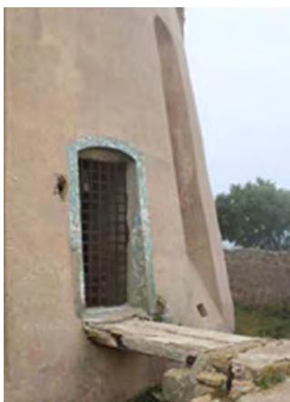
Pintadas y marcas vandálicas.
