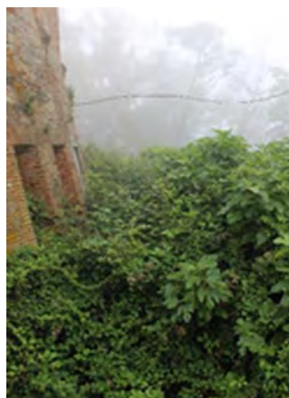
Accesos colmatados por la vegetación.
