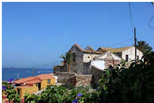
Cubiertas hundidas y riesgo de desplome del conjunto por falta de arriostramiento.
