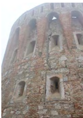
Grieta presente en la edificación
