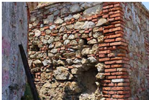
Pérdida de fábrica y revestimiento.
