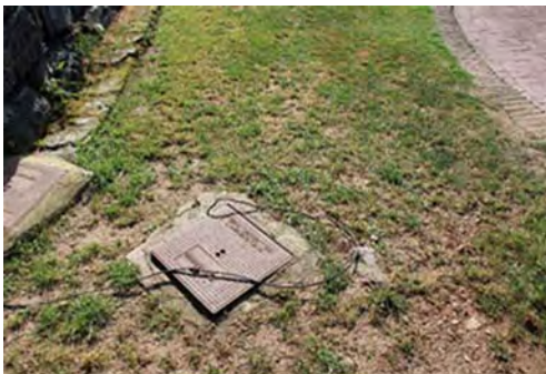
Problemas con las instalaciones del lugar.
