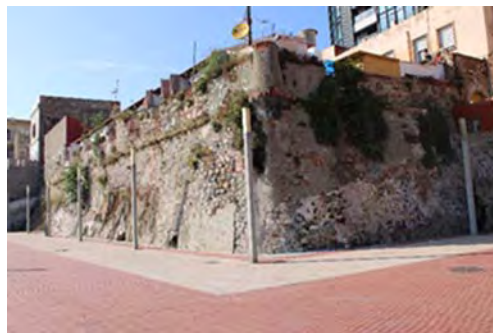
Desprendimientos de material y piezas.
