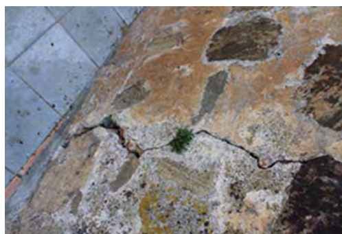
Presencia de vegetación parasitaria.
