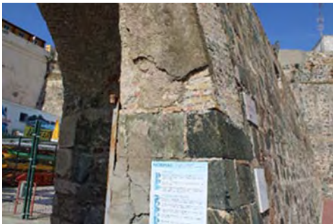
Pérdida del material y elementos oxidados.
