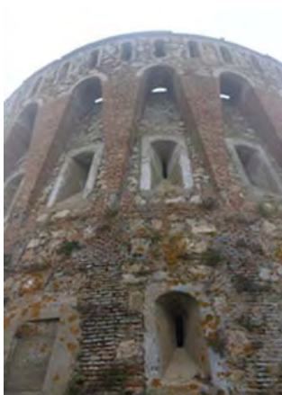
Líquenes y moho en la fachada.
