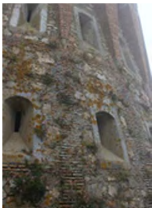
Vegetación parásita y presencia de moho y líquenes
