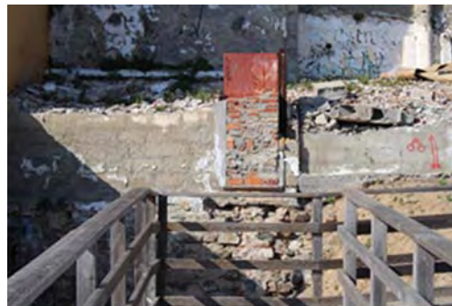
Suciedad y pintadas vandálicas.
