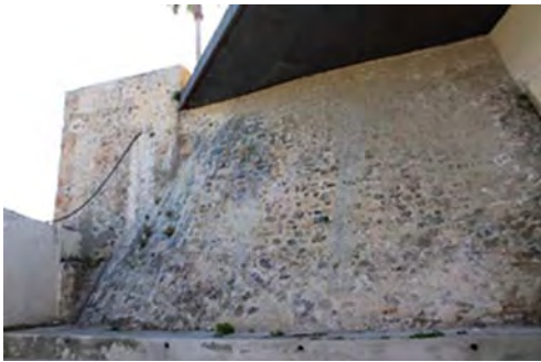
Vegetación parasitaria y humedad en el encuentro con la edificación colindante.
