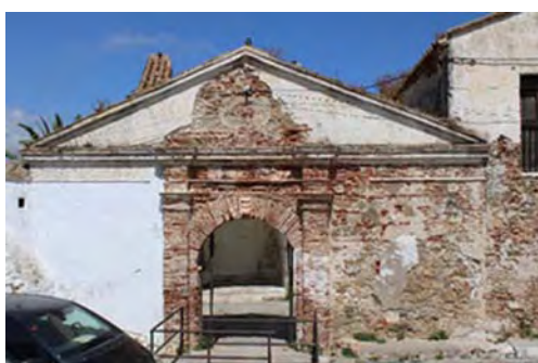
Anidamiento y palomas en el edificio. Pérdidas de revestimiento.
