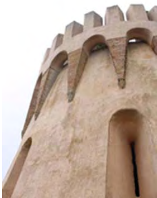
Suciedad generalizada y vegetación parasitaria en cubierta.
