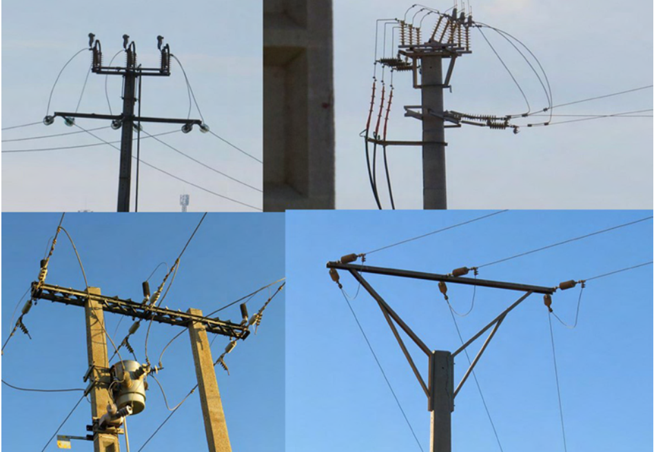
Fotografía 5. Aspecto de los distintos apoyos encontrados en el entorno de los humedales del norte de Marruecos, que por su peligrosidad pueden causar la muerte por electrocución de águilas pescadoras.
